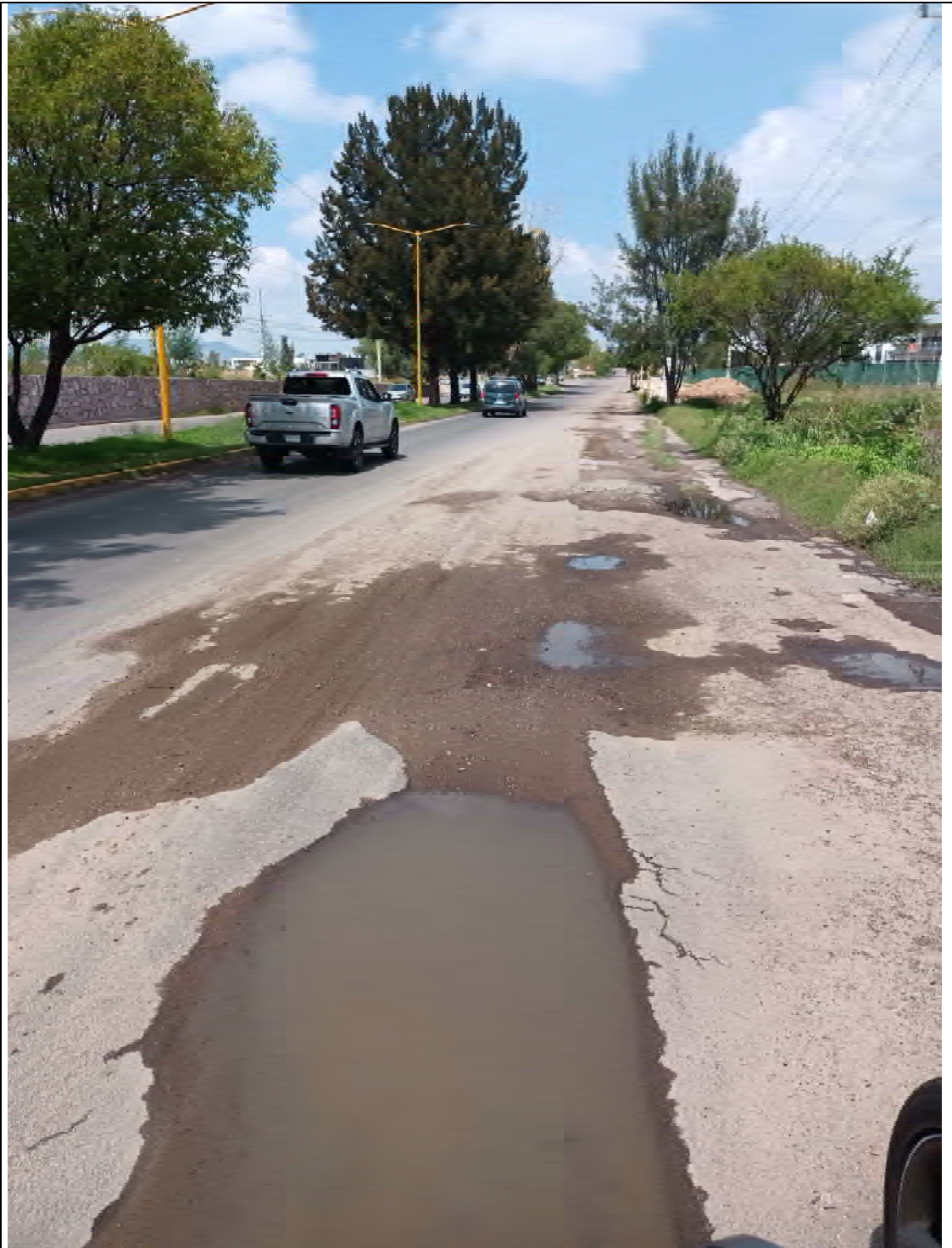
Se puede apreciar la característica típica de la vialidad, tramos en muy mal estado, COORDS.: LAT. 21.909647° LONG. -102.330134°.
