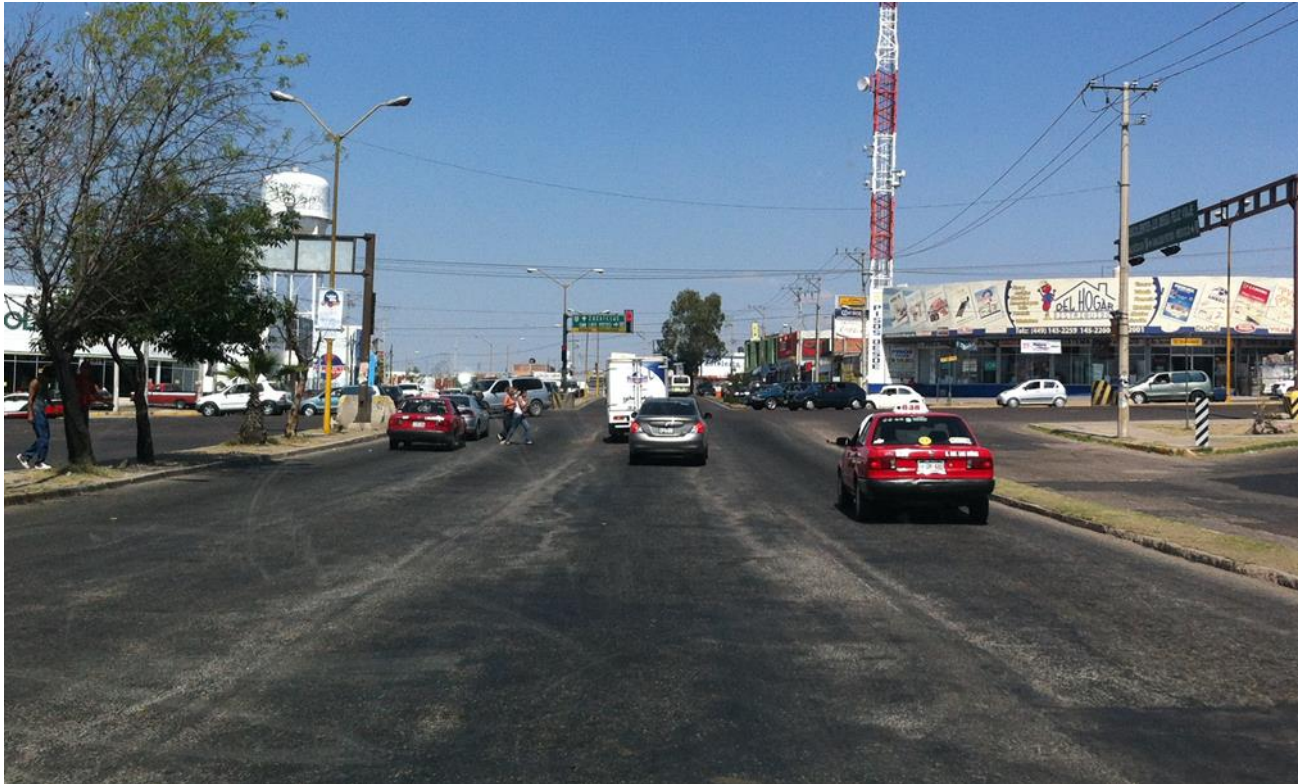
Figura 7 Condiciones de pavimento en Blvd. Siglo XXI casi esquina Carretera 70 Oriente
