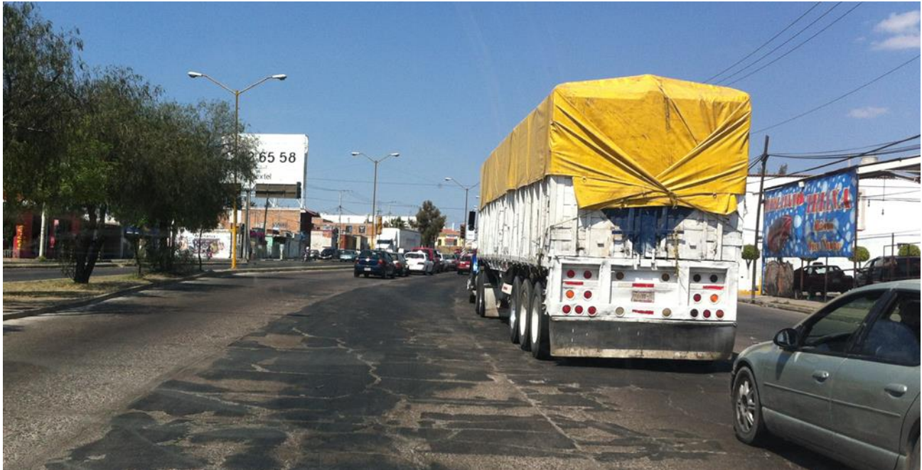
Figura 8 Condiciones de pavimento en Blvd. Siglo XXI casi esquina Av. Esfuerzo Nacional
