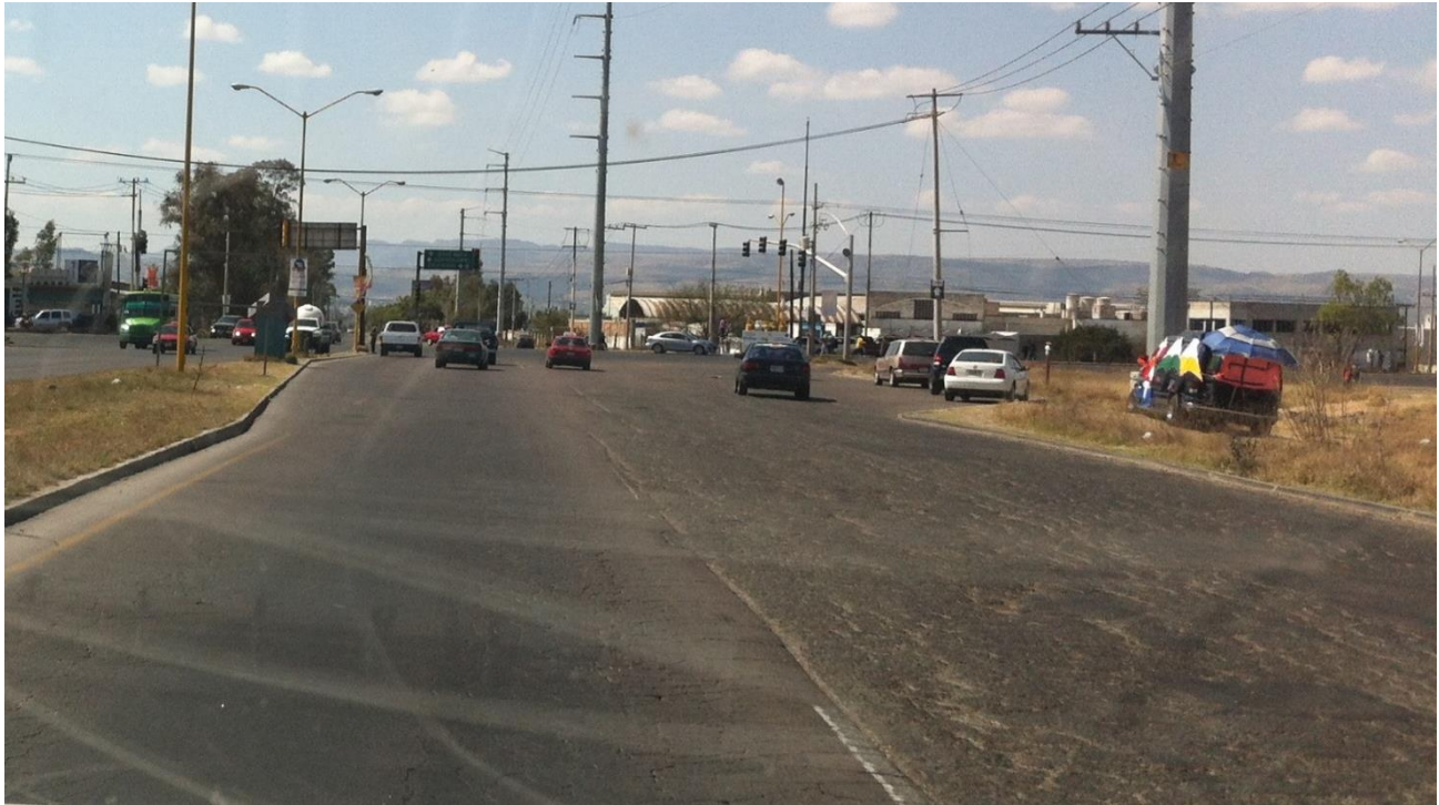
Figura 10 Condiciones de pavimento en Blvd. Siglo XXI casi esquina Carretera 45 norte
