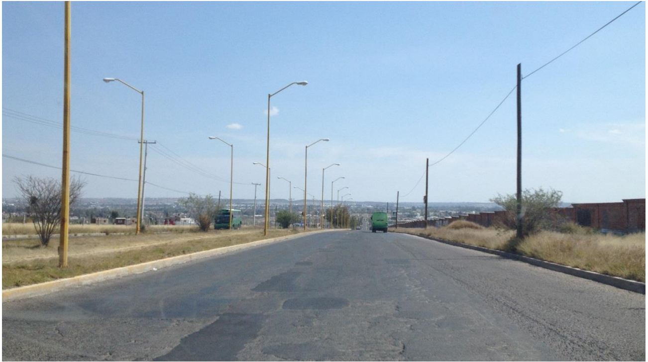
Figura 3 Condiciones de pavimento en Blvd. Siglo XXI casi esquina Av. Juan Pablo II
