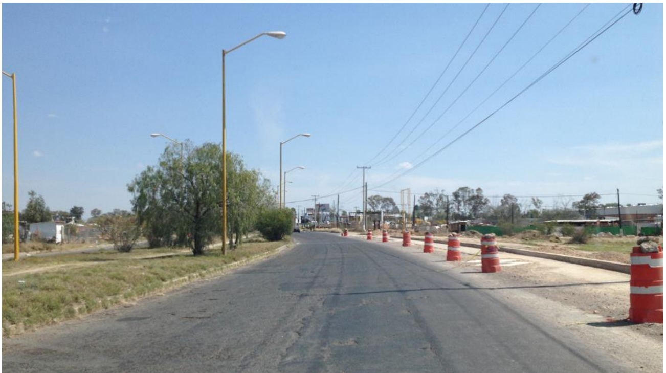
Figura 4 Condiciones de pavimento en Blvd. Siglo XXI casi esquina Av. Agostaderito
