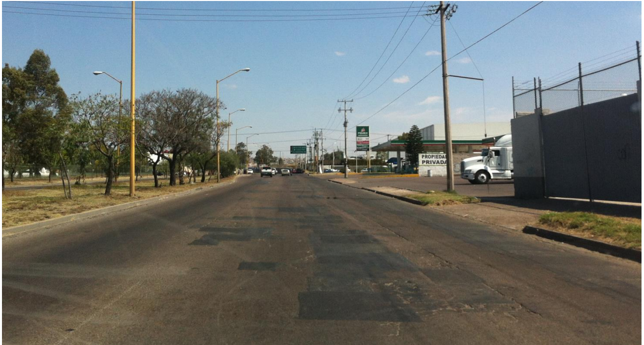
Figura 5 Condiciones de pavimento en Blvd. Siglo XXI casi esquina Av. Héroe de Nacoziari
